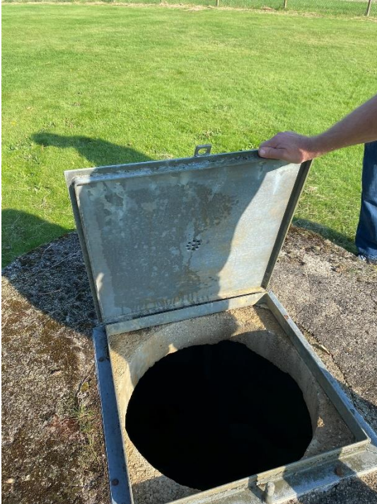
Foto 1 – Gummiliste er skrælet væk ved boring 76.1438
