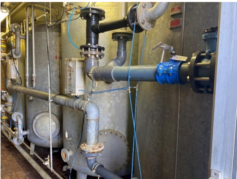
Foto 2 – Filteranlæg er af ældre dato, og bør udskiftes snart
